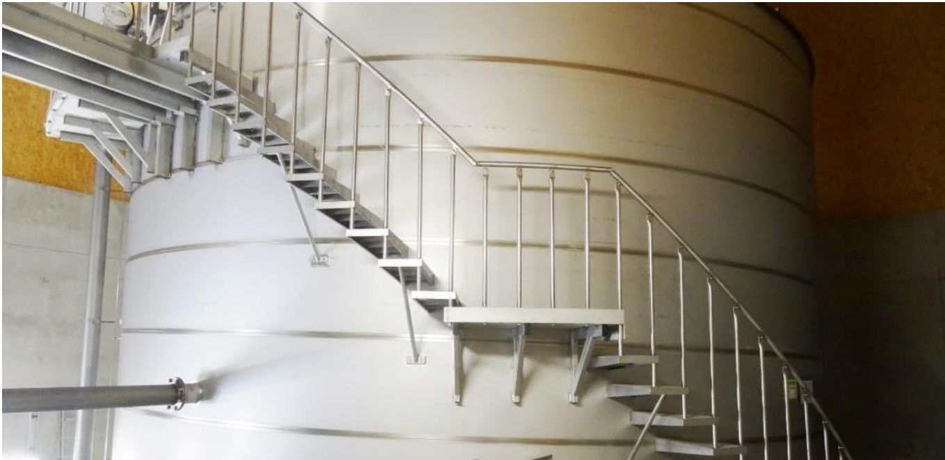
Abbildung 26: Edelstahltank des Hochbehälters
