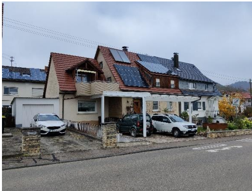
Abbildung 71: PV-Dach in der Schillerstr. 2-4
